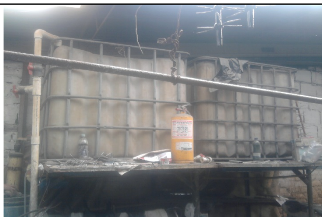
Foto No. 4. Sistema de tratamiento de las aguas residuales de procesos galvánicos
