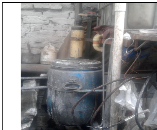
Foto No. 3. Filtro de Carbón activado
